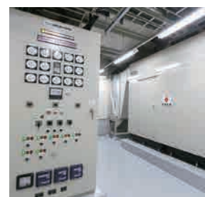
自家発電装置
